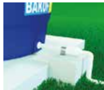
FIXAR COM abraçadeiras PARA EVITAR golpes hidráulicos. É NECESSÁRIO COLOCAR O CALÇÓ.
